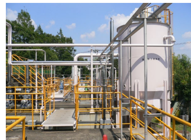
排水処理設備（板倉工場）
