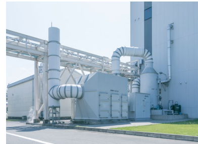
脱臭設備（板倉工場）
