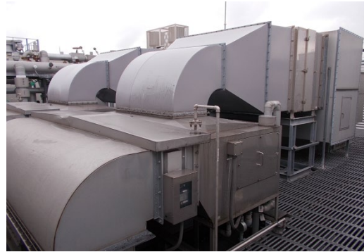
脱臭設備（総合研究所）
