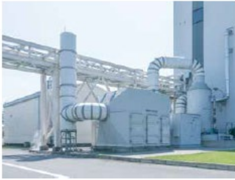
脱臭設備（板倉工場）
