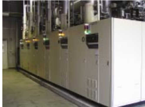
新設ボイラー( 板倉工場 )
