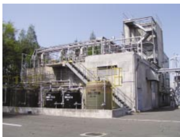
排水処理設備(長谷川ファインフーズ)
