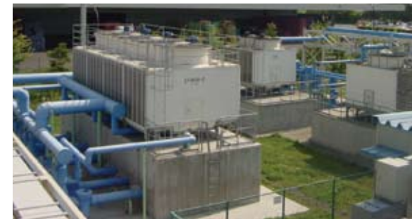
水循環設備 (板倉工場)
