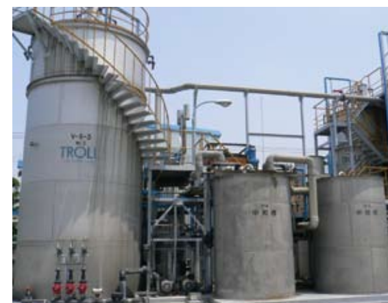
排水処理施設（深谷工場）
