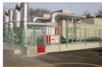
コージェネレーション (重油) 設備 (板倉工場)
