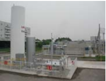
コージェネレーション (LNG) 全景 (板倉工場)
