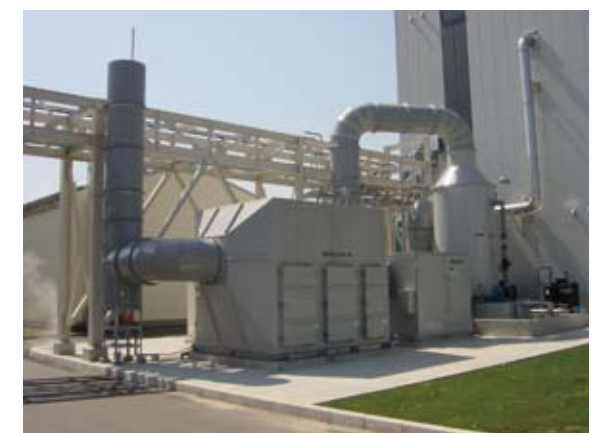
脱臭設備（板倉工場）
